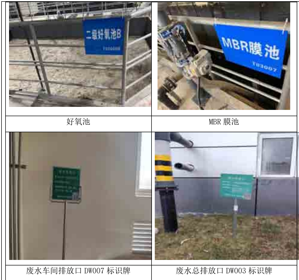
图 3.2-2 废水处理设施现状照片
