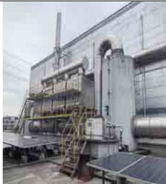
焚烧车间临时暂存库废气处理设施
