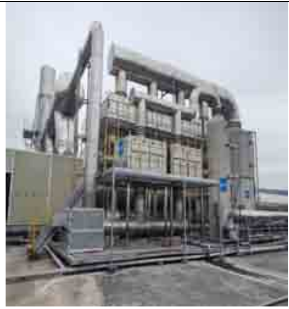
5#暂存库废气处理设施
